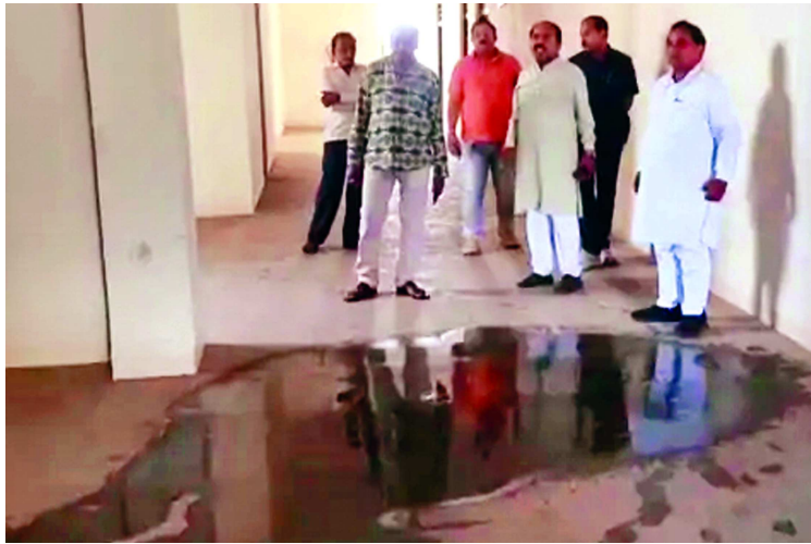
के बाद लोगों ने निर्माण कार्य की कहना है कि करोड़ों रुपए खर्च होने के गुणवत्ता पर सवाल उठाए हैं। उनका बावजूद भवन पहली बारिश भी नहीं झेल
